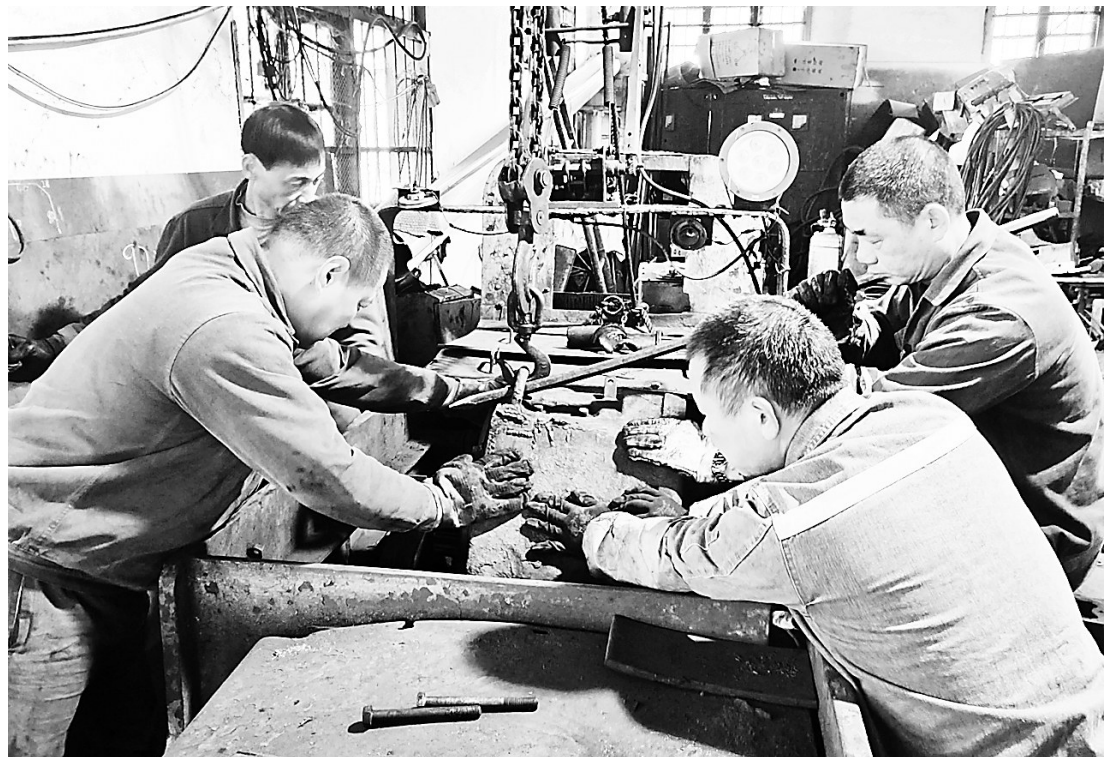
新年伊始,福建煤电公司龙潭煤矿机电部门为设备建立“健康”档案,狠抓机电设备完好率,精准开展井下架线电机车维护,以设备硬保障筑牢生产安全防线。图为近日,机车维修班工作人员在维修车间精准吊装电机车电机作业场景。(陈思忠 摄)
