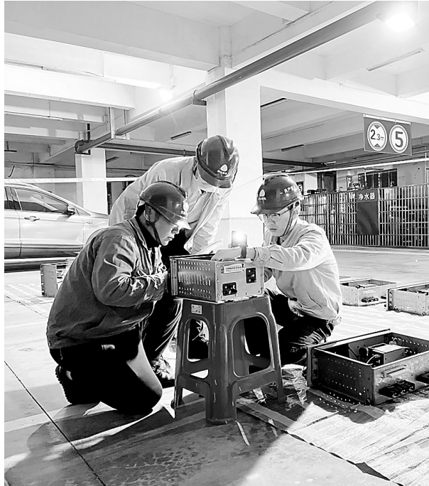
近日,鸿山热电公司电气专业按照年度检修计划,抢抓夜间时段,加班加点、攻坚克难,高质量完成生办楼01A段检修任务,实现一次送电成功。(颜宏达 摄)
