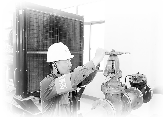
图为余秋城在消防泵房专注调试压力
