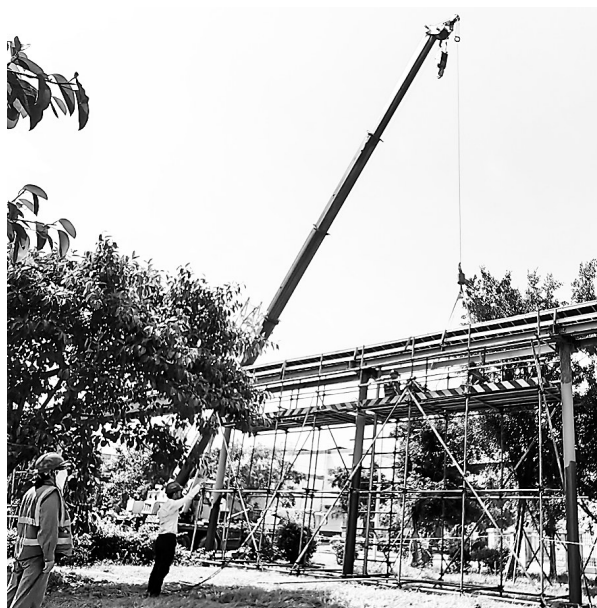
鸿山热电公司汽机专业以“防患于未然”为原则,将管架维护纳入专业重点工作,于近日全面启动腐蚀专项治理行动,进一步提升管架使用寿命,保障生产设施安全稳定运行。(谢涛 摄)
