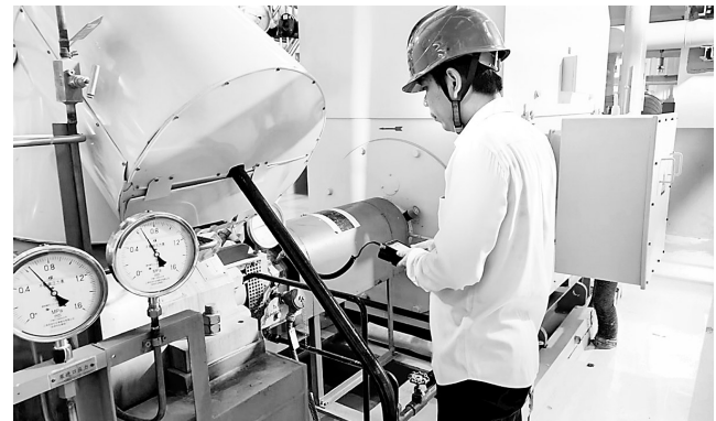
近日,龙安热电公司设备管理部检修人员在高温环境中坚守岗位,用身影在热浪里刻下责任的印记。图为检修人员在细致地检查给水泵。(涂瑞兴 摄)
