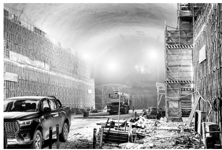
木兰抽蓄地下主厂房
