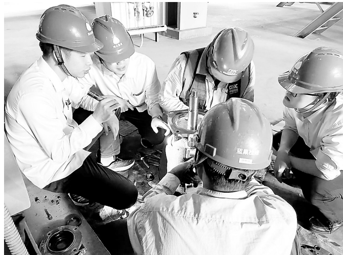
图为该公司锅炉专业利用检修期间开展技术培训
