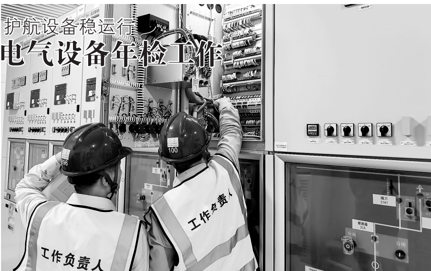
图为检修人员在检查开关柜
