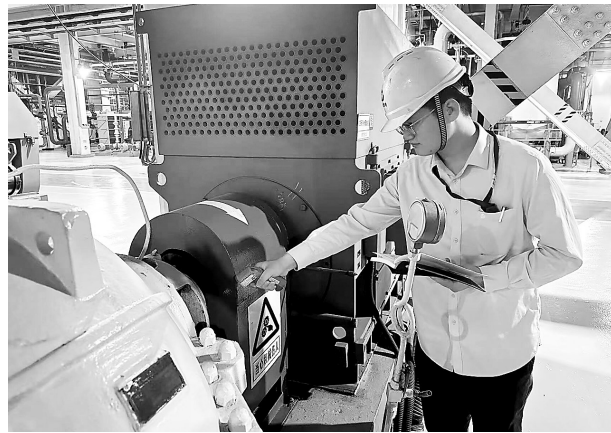
为确保迎峰度夏期间转机设备安全稳定运行,鸿山热电公司运行人员提前谋划,以“零死角巡检+精准测温”为抓手,筑牢设备安全防线。图为近日运行人员对转机设备进行红外测温。(郝捷 摄)
