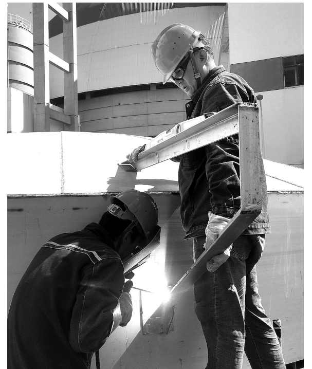
▲ 年初以来,晋南热电公司多项技术改造项目有序推进,其中化水二级反渗透按计划顺利推进,经过一周持续施工作业,容积500立方米的除盐水罐加工完成。图为施工人员正在现场进行除盐水罐体的加工焊接。(周国利 摄)
