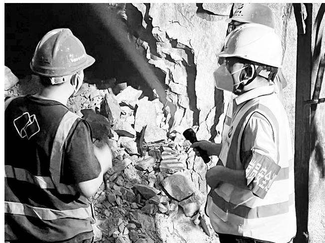
▲ 5月12日,花山抽蓄第二支部党员先锋队深入长探洞及钢筋加工厂,开展专项安全督查活动。重点检查洞内支护结构的稳定性、通风排水系统的运行状况以及施工设备的安全性能。党员们一边检查,一边向现场工人普及安全知识,强调安全生产的重要性。(王新枝 摄)
