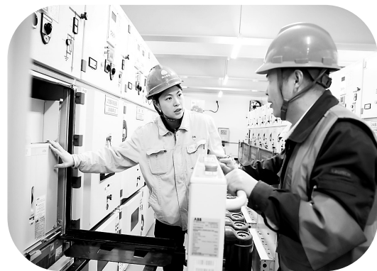
图为陈梅在进行6kV开关柜检修
