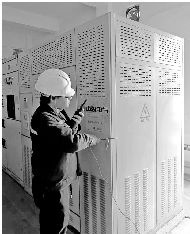
为有效预防和减少雷电灾害事故的发生,新材公司权属泉州公司于近日全面开展2025年度春季防雷检测工作,检测工作覆盖了灰库、配电室等重点区域和关键设备,确保生产设备安全稳定运行。(詹建洲 摄)
