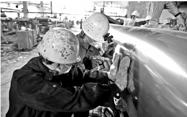
3月19日,福维公司4#水洗生产线技改施工人员正在加班加点进行设备安装。今年来,该公司深入开展“生产组织和生产精细管理年”活动,充分利用闲置设备推进水洗生产线产能扩建技改,进一步提高产品差异化率。(陈福华 摄)
