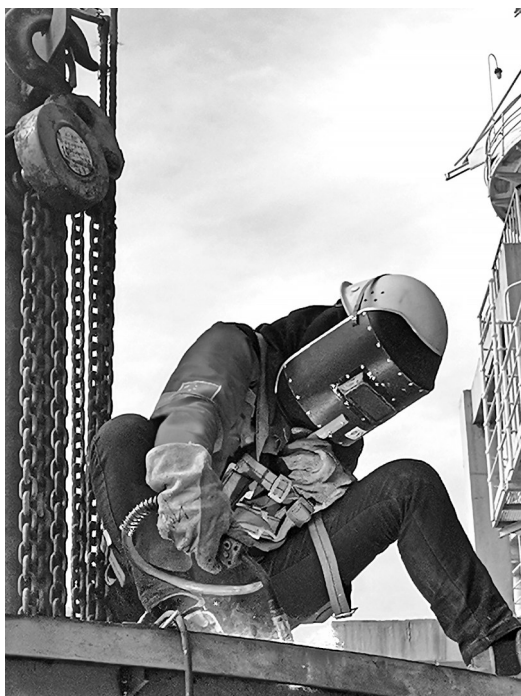
为保持开门红的良好势头,近日,晋南热电公司强化生产巡检和设备消缺,全面推进技术改造,确保了稳发多供与安全生产。(周国利 摄)
