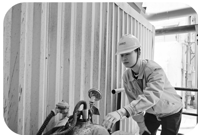
图为陈伟涵对1号炉2次风机认真巡检
