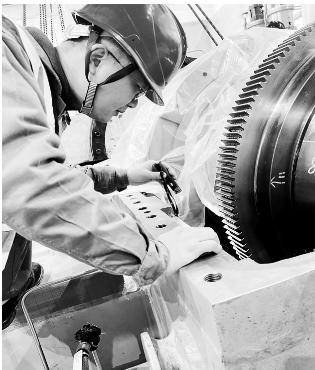
▲ 近日,龙安热电厂开展年度检修工作,对公司设备进行综合检验,以“严细实新”推进设备管理与人员素质双提升。图为汽轮机进出油管道封堵检查。(涂瑞兴 摄)
