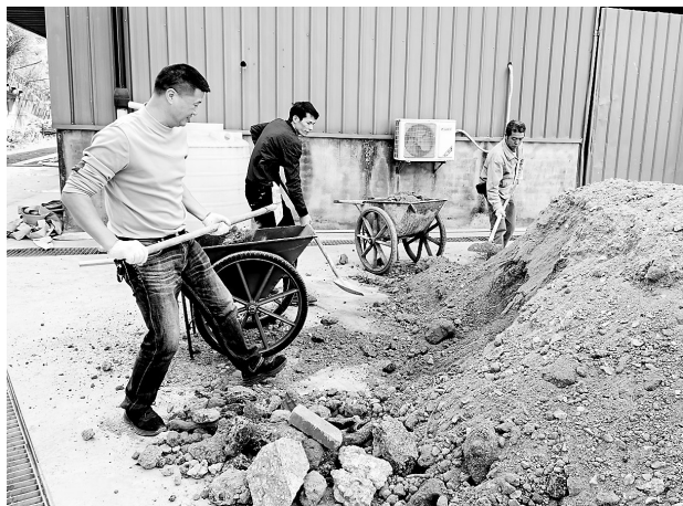
▲ 近日,建材控股厦门公司骨料堆场后侧出现下陷问题情况,给公司的日常运营安全带来潜在风险。该公司员工主动请缨,对下陷区域进行推土填埋,解决下陷问题的安全隐患。(梁瑞和 摄)
