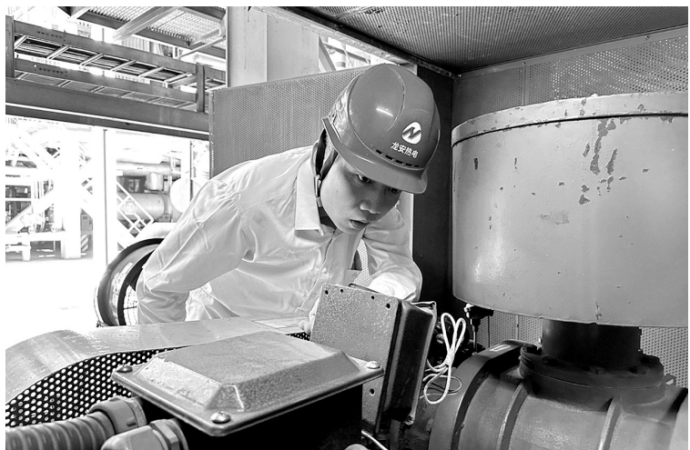
中秋佳节,龙安热电公司员工默默坚守岗位,一如往常消缺检修、忘我工作,用行动守护着设备稳定运行。(涂瑞兴 摄)
