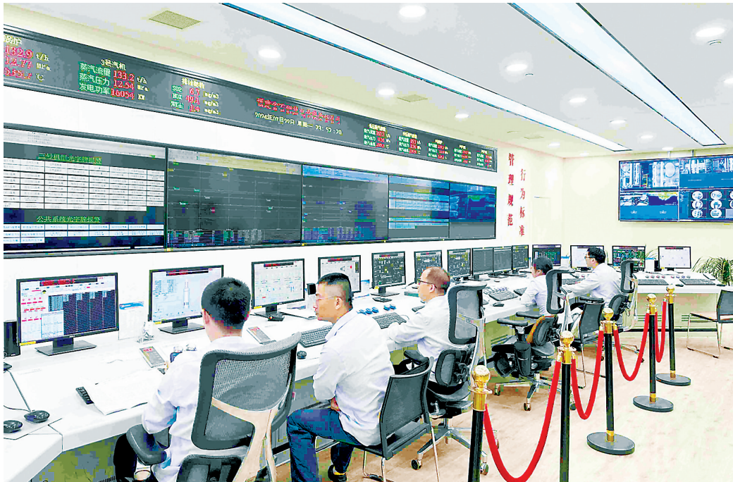
近日,为确保迎峰度夏时期安全生产运行,石狮热电厂员工以时刻紧绷的“安全弦”、全力以赴的“战备状态”奋力守护机组安全稳定运行。(张权 摄)
