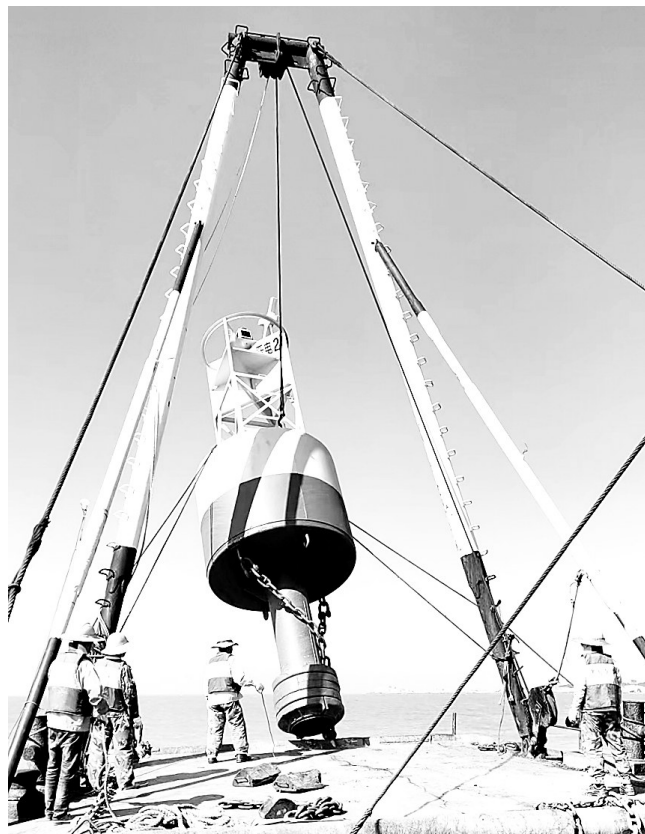
▲ 8月1日,晋江气电公司因台风受损晋电2号水上航标灯顺利完成抢修,进一步保障了所在水域过往船舶航行安全及取水设备安全。(王素环 李秋明 摄)
