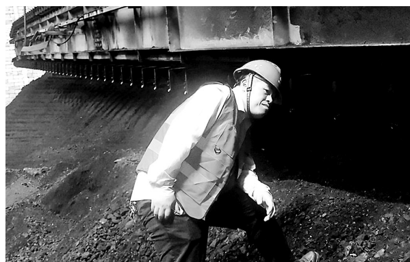
针对入夏以来的高温酷暑影响,晋南热电公司设备维护部加强生产设备的检查维护与保养,保证迎峰度夏的安全形势。图为设备维护部的热控人员在煤场检查堆取料机刮板俯仰限位开关状况。(周国利 摄)
