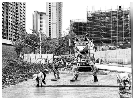
近日,龙岩美伦·生态城项目部对项目现场出入口道路进行混凝土硬化施工。图为施工工人头顶烈日挥汗如雨进行混凝土浇筑工作。(徐宗鹭 摄)
