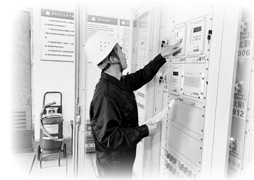
图为林建峰正在查看微机综合保护装置
