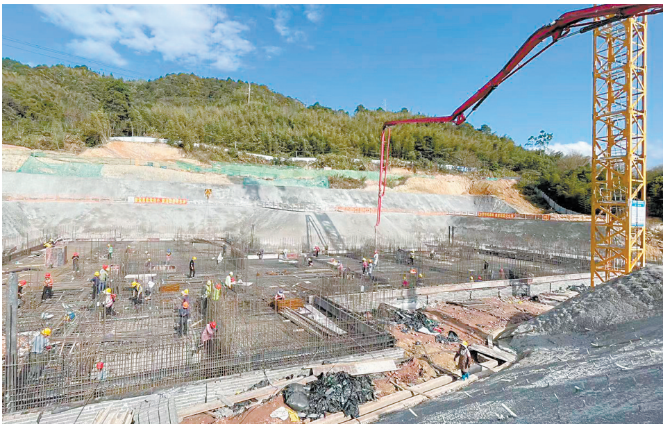
▲临近春节,建材控股龙岩混凝土公司员工秉承着“服务至上”的服务理念,坚守岗位。2月6日,该公司相关岗位人员前往“龙岩市疾控中心异地迁建项目”工地进行现场查勘,保障混凝土的正常供应。(邱磊 摄)
