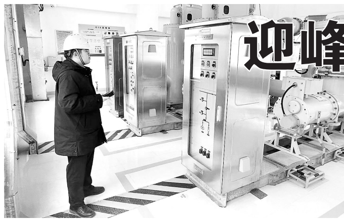
运行部巡检人员对110kV出线段开关运行状态进行巡检。
