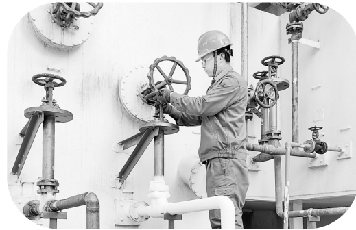
图为陈力钊在操作膨胀机进口阀门(张王海 摄)
