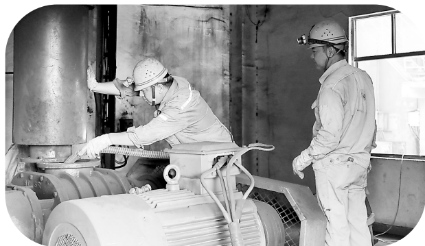
“双节”期间，福建水泥永安建福公司员工依然坚守岗位，创先争优，实干争效。图为该公司员工正在疏通设备堵料。（香杰 刘朝霞 摄）
