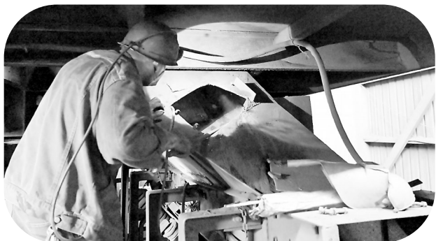
福建煤电公司龙潭煤矿机电部门全力做好节日期间矿井机电设备安全运行工作。图为10月5日，检修人员正在排查维修皮带输送机下煤口设备故障。（陈思忠 摄）
