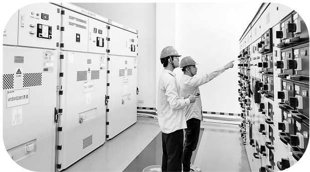
“双节”期间，为确保电力保供，福能海峡公司陆上集控站维检人员坚守岗位，确保设备顺利通过验收。图为维检人员正在现场巡检。（朱思杰 摄）
