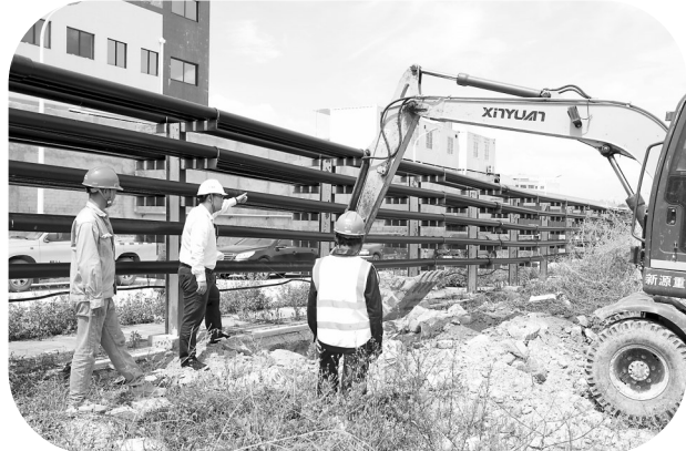
“双节”假期，鸿山热电公司一线人员坚守在岗，全力做好“双节”期间各项工作。图为该公司全力以赴推进供热管道延伸段项目建设进度。（吴鑫鑫 摄）
