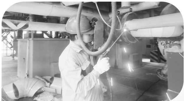
“双节”期间，石狮热电公司员工坚守在岗位上，用行动诠释责任担当。图为检修人员正在检修锅炉。（苏永洪 摄）
