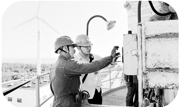
“双节”期间，晋江气电公司保运人员依然坚守在生产一线，时刻盯紧生产现场安全，严密监视机组运行参数，全力保障机组安全稳定运行。图为检修人员正在消缺工作现场。（王素环 摄）
