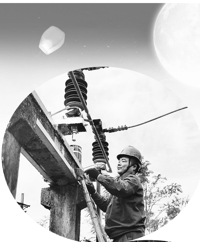
“双节”将至,福建煤电电力安装检修公司运行人员与维修人员正在对设备进行巡视、检测与维护,确保辖区电力可靠供应。(张萍 摄)
