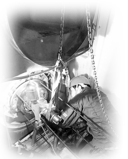
图为沈煜潮在检修发电机轴承
