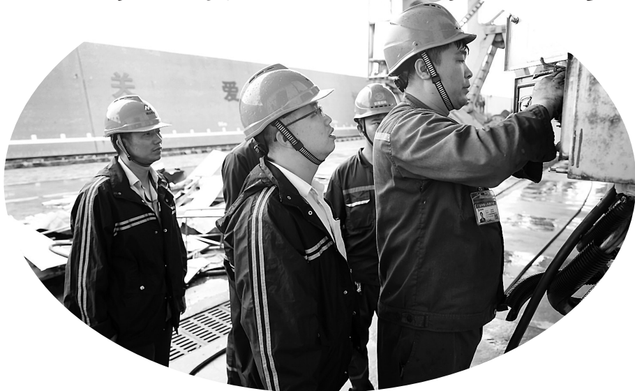
图为该公司燃料点检人员迅速开展台风过后卸船机修复工作
