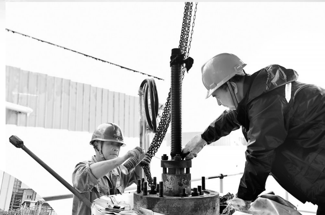
9月6日，为尽快消除设备缺陷，恢复机组备用，晋江气电公司检修人员抢抓雨势较弱间隙进行检修作业。图为该公司检修人员正对1号锅炉高压主汽电动门进行检修。 (王素环 摄)
