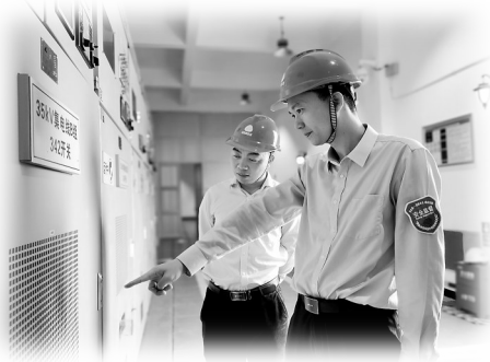
图为张孔飞(前)在风电场安全检查
