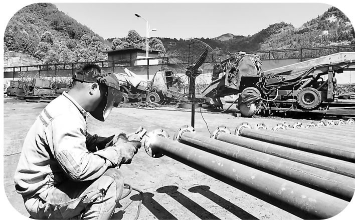
▲近日,永安煤业公司苏桥煤矿机运队机修班人员顶着烈日,正在给井下供风、供水使用的钢管进行焊接、上漆,为采掘一线提供优质后勤服务保障。(郑震恺 摄)
