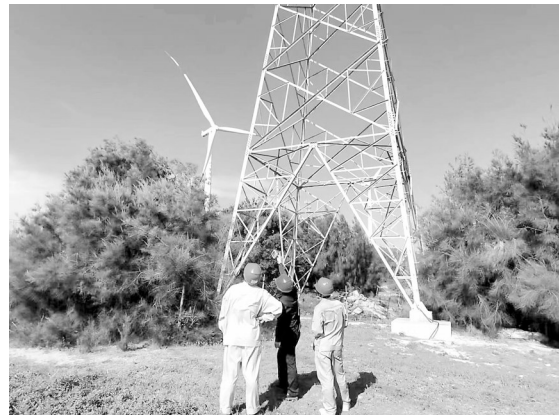
图为工作人员正在确认隐患点
