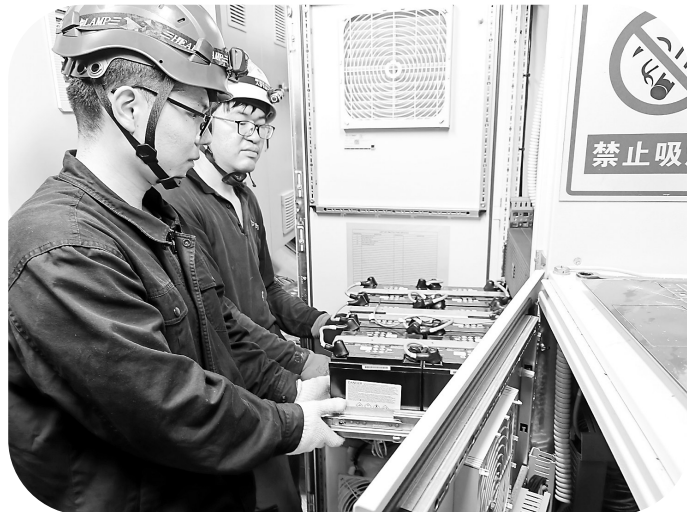
图为作业人员正在做好风机设备点检工作。
